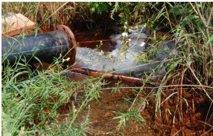
Рис. 3.37. Выход вод техногенного комплекса шахты «Углекаменская» на участке «Старая насосная»
