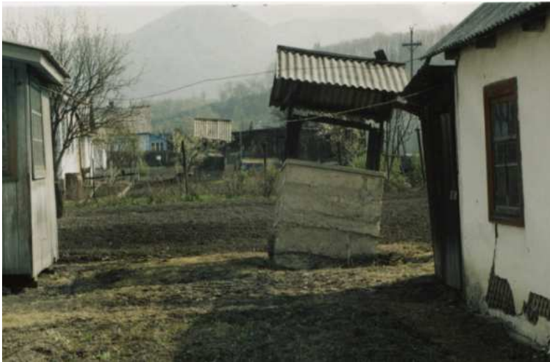
Рис. 3.44. Деформация колодцев над выработанным пространством шахты «Авангард»
